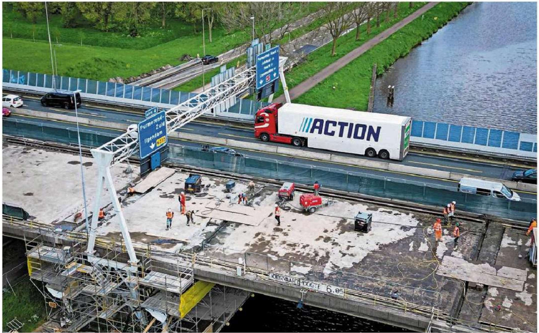
Onder meer winkelketen Action, met een groot distributiecentrum in Zwaagdijk-Oost, maakt gebruik van de zwakke brug bij Purmerend.
